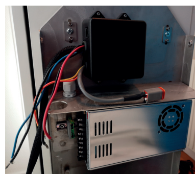
4. Styrbox och transformator på montageplåt
